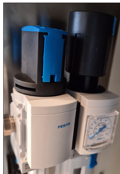
Persluchttafsluiter in gesloten stand
